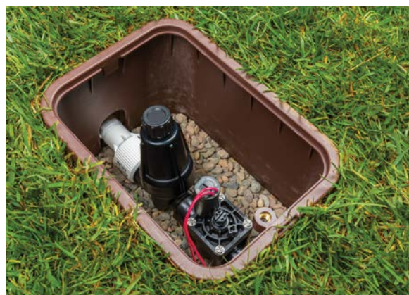
PCZ-101 instalado en una arqueta polivalente
