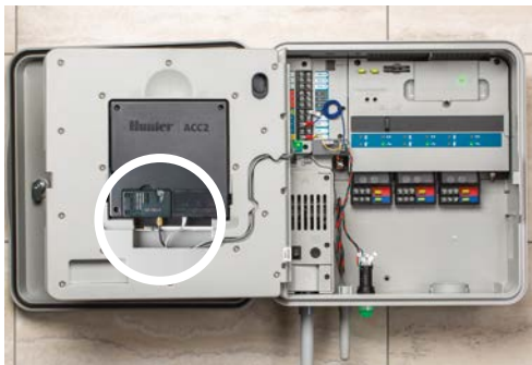
Programador ACC2 con módulo A2C-CELL-E instalado
