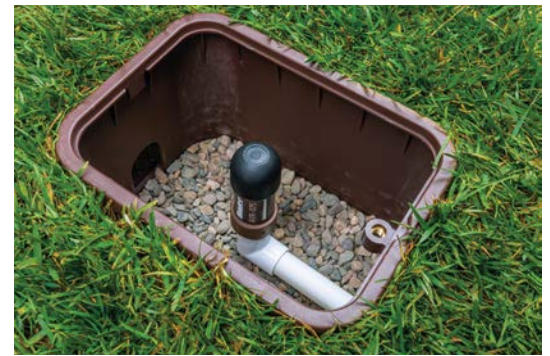
Válvula de ventosa de aire/vacío instalada
